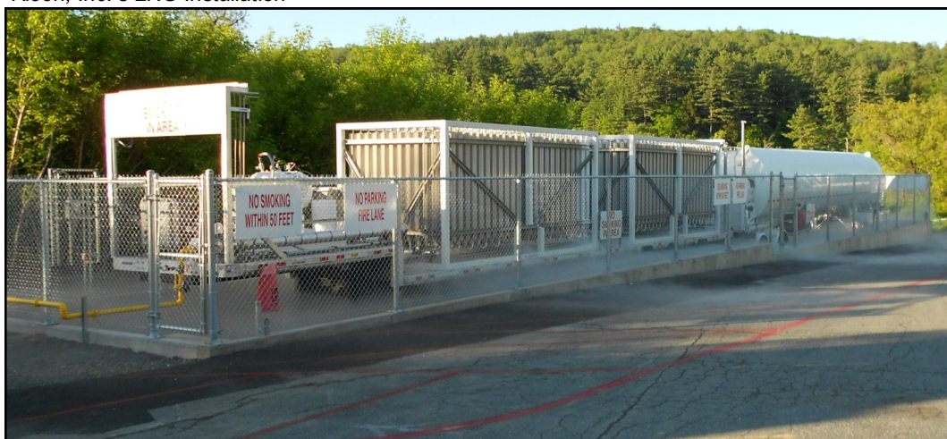
Kleen, Inc.'s LNG Installation
